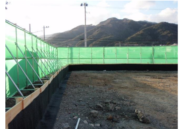
土砂流出防止柵の裏側 (流出防止マット)
