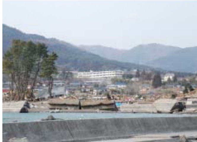
末崎町 太田団地防潮堤 破壊された防潮堤
