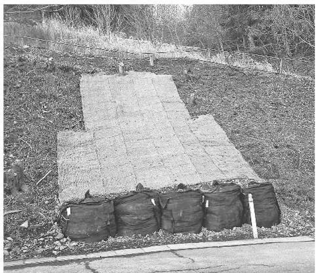
台風10号による被害
