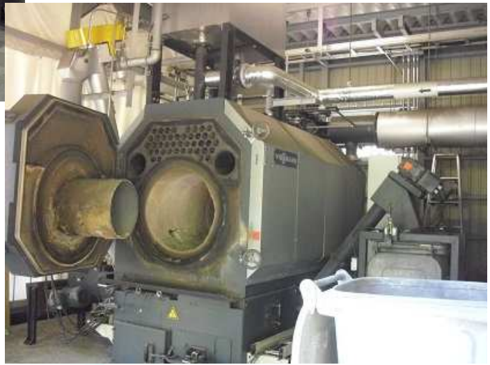
竹を大量に消費できる竹チップボイラー
