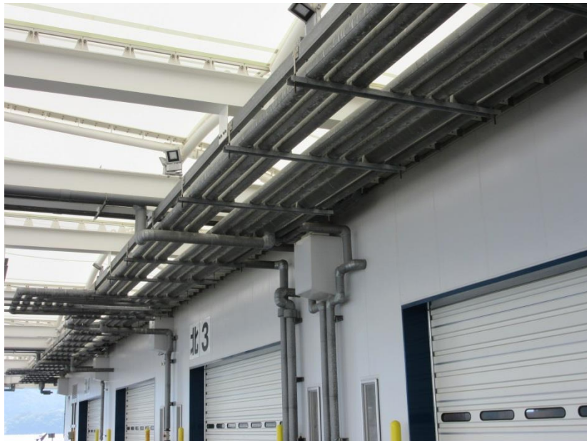
【岸壁上屋配管】
