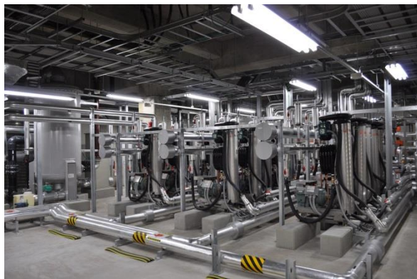
【製氷施設（内部）】
