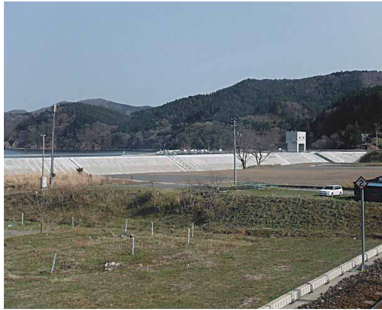
引き続き水門の機械設備工事が行われる下甫嶺地先海岸
