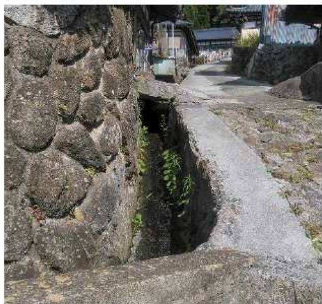
台風19号のときに氾濫した水路
