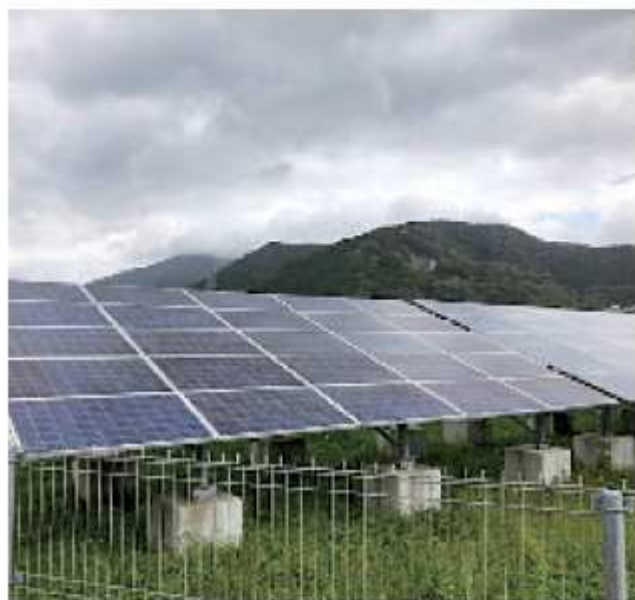
太陽光パネル
