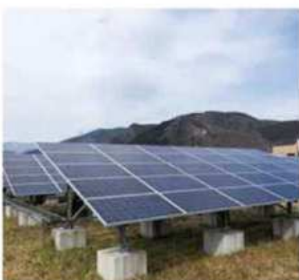
市内に設置されている太陽光パネル
