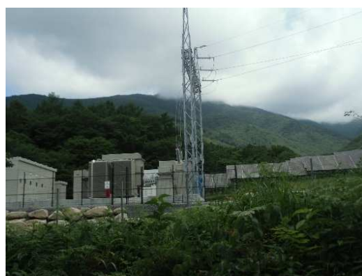
五葉山太陽光発電所
