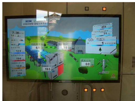
吉浜地区拠点センターに設置された 太陽光発電・蓄電池システム
