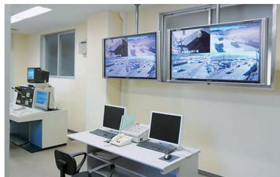
遠隔制御操作卓
