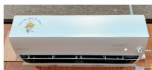
根白会館の設置状況
