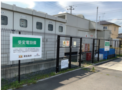
受容電設備 非常用発電機
