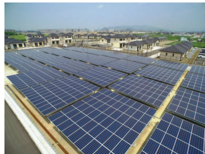
防災調整池ミドルソーラー
