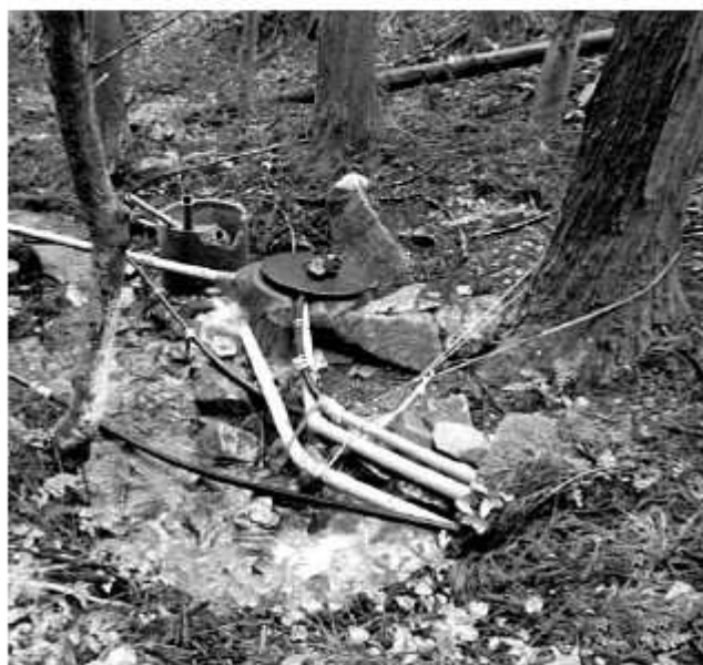
未給水地域の第二貯水タンク
