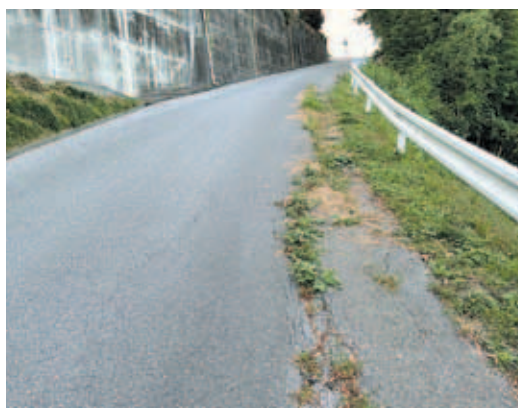
劣化していく私道
